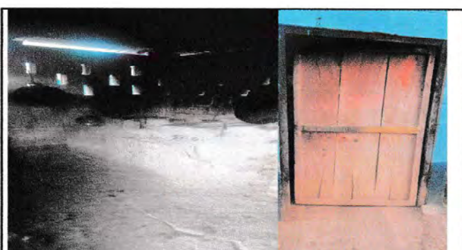
Foto 5: Torta y paredes desgastadas, en malas condiciones, puerta de madera en malas condiciones
