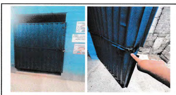
Foto 6: Puertas de baños no funcionales, necesitan reparaciones seguidas para tener los baños cerrados
